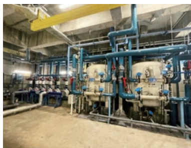
【ろ過循環機械室】
